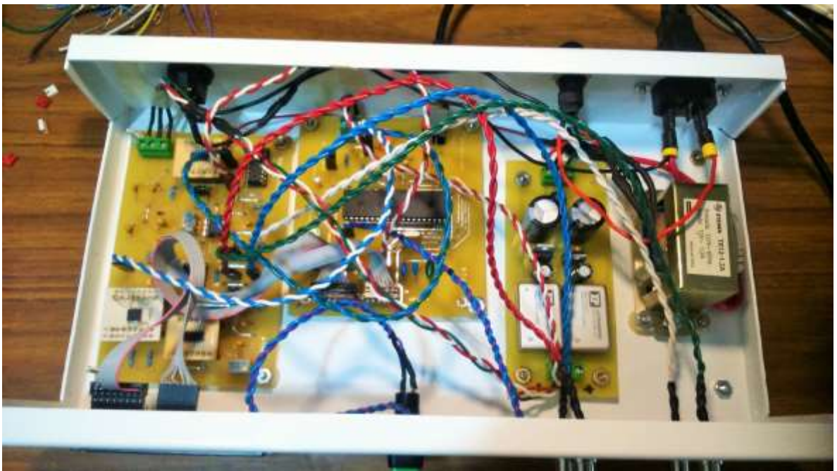
Fig. 40 Conexión de las placas y de la fuente de poder en el gabinete, vista superior.
