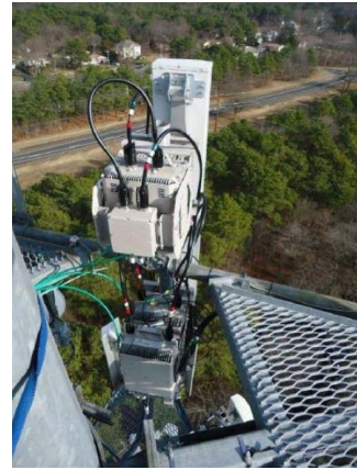
Figura 5. 1 Vista de una moderna instalación con varios transreceptores detrás de la antena de estación base [60]
