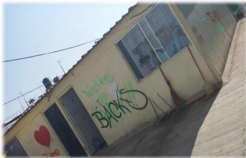
Figura 4.13 Aulas ocupadas por el CHEP. Es un lugar que no debería existir. (Ángel, estudiante, abril 12 de 2015),
