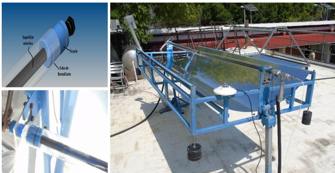
Figura 39. Montaje del tubo de Cu/Ni/BC en el concentrador cilindro parabólico (CCP).
