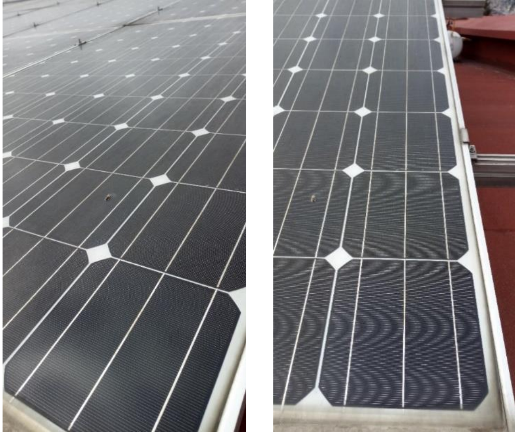
Figura 39. Fotografías de los paneles FV después de la lluvia en los días 19 (izquierda) y 20 (derecha) de enero. La suciedad se ha eliminado casi completamente.
