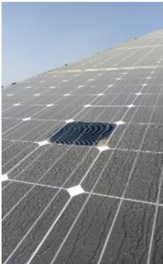
Figura 36. Soiling acumulado sobre los módulos del SFV del Cinvestav Zacatenco al día 17 de diciembre de 2019. Se limpió una celda para hacer visible la capa de suciedad.
