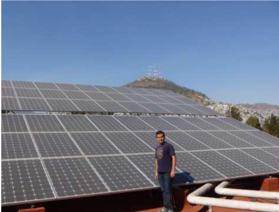
Figura 34. Segmento del SFV del CINVESTAV Zacatenco de 60 kWp [55].
