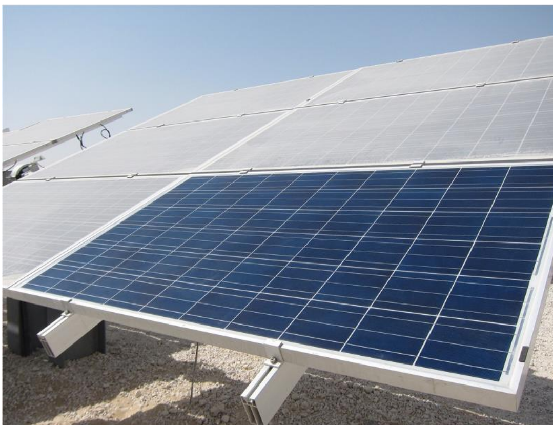
Figura 11. Un módulo limpio en un arreglo con un mes de acumulación de suciedad en la instalación de pruebas solares QEERI en Doha, Qatar [10].
