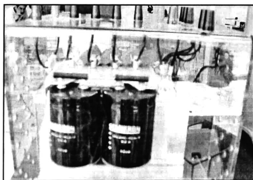
Figura 8. Vista trasera del módulo de potencia (capacitores del rectificador).
