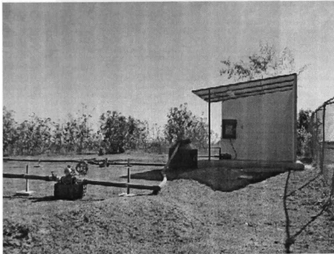
Figura 2.6: Caseta de pruebas
